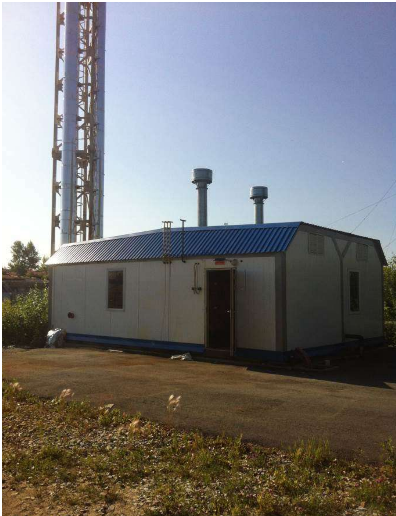
Рис.5. Котельная г. Сысерть (ул. 4-й Пятилетки, 2а).
