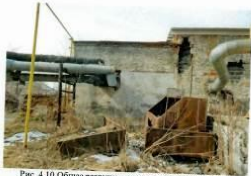
Рис. 4.10 Общее разрушение внешней несущей стены
