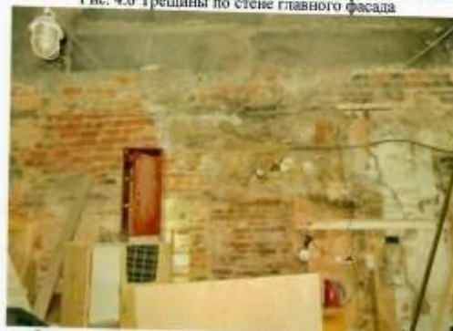
Рис. 4.8 Разрушение кирпичной кладки несущей стены
