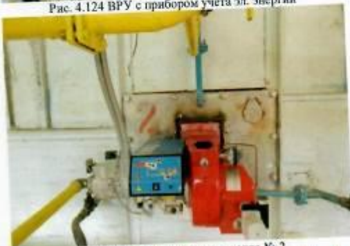
Рис. 4.126 Газовая горелка котла № 2
