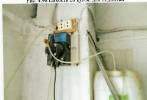
Рис. 4.98 Дозатор хим. водоподготовки с канистрой реагентов СК-110
