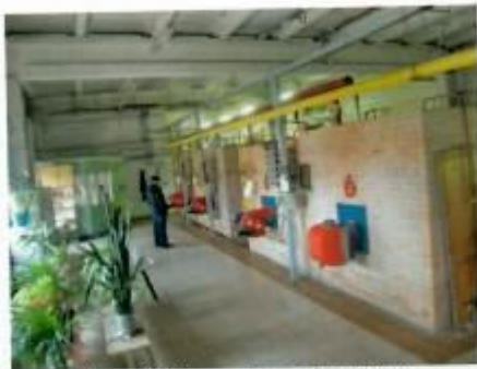
Рис. 4.85 Водогрейные котлы (4 шт.)
