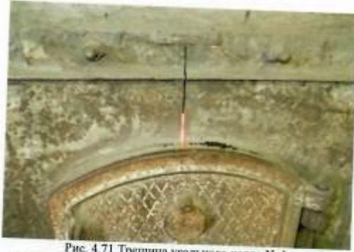
Рис. 4.71 Трещина угольного котла № 1
