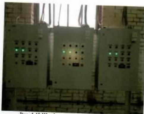
Рис. 4.48 Шкаф управления котлами (Зигт)
