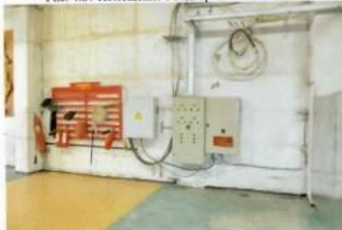
Рис. 4.89 Шкафы управления и учета
