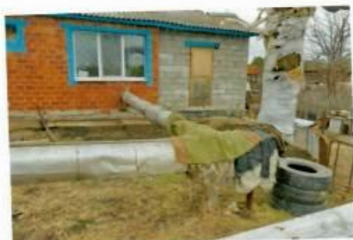
Рис. 4.137 Ввод в жилой дом. Разрушение теплоизоляции
