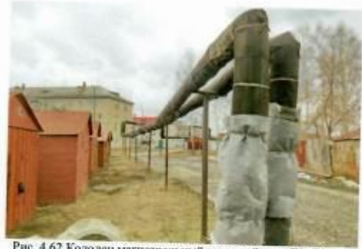
Рис. 4.62 Колодец магистральный тепловой сети Т1иТ2
