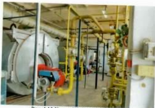
Рис. 4.13 Котлы КВ-ГМ-3-115 (3 шт.)
