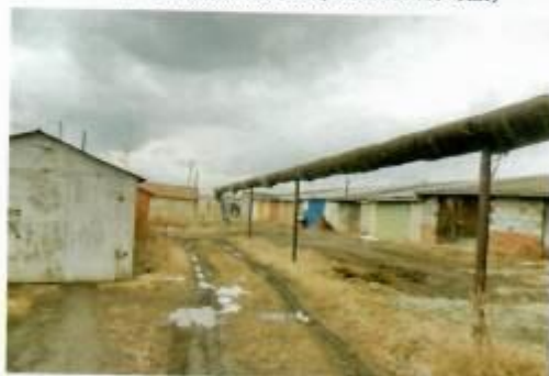
Рис. 4.59 Надземный участок магистральной теплосети
