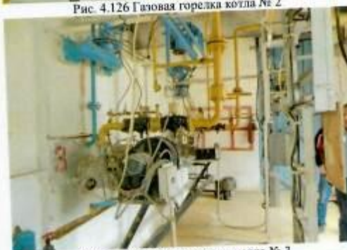
Рис. 4.128 Газовая горелка котла № 3
