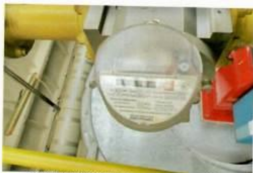
Рис. 4.21 Прибор учета расхода газа котла № 3
