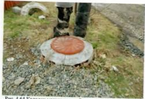
Рис. 4.64 Колодец магистральный тепловой сети Т1иТ2
