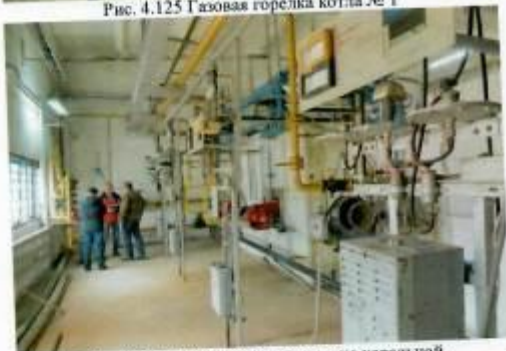
Рис. 4.127 Внутреннее помещение котельной
