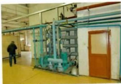
Рис. 4.93 Насосное оборудование котельной
