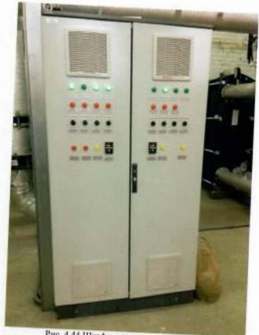
Рис. 4.44 Шкаф управления насосами
