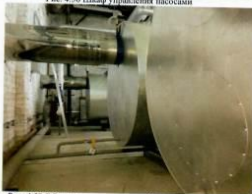
Рис. 4.58 Общий вид котлов сзади (КВ-ГМ-3-115 -3шт)
