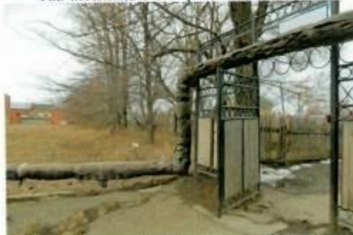
Рис. 4.103 Надземный переход теплотрассы над проездом
