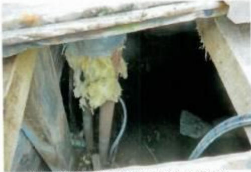
Рис. 4.101 Колодец магистральный тепловой сети
