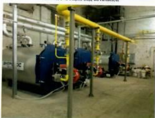
Рис. 4.57 Общий вид котлов (КВ-ГМ-3-115 -3шт)
