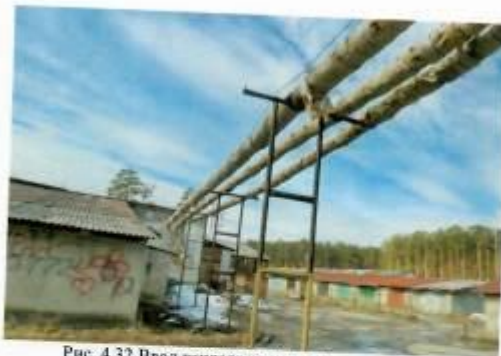
Рис. 4.32 Ввод теплотрассы в здание котельной
