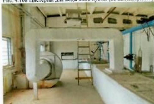
Рис. 4.110 Дымоход внутри помещения котельной
