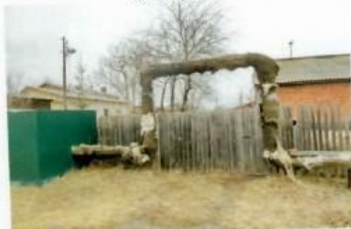
Рис. 4.134 Переход теплотрассы над проездом к жилому дому
