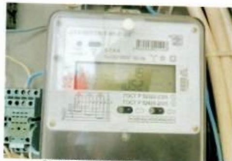
Рис. 4.18 Прибор учета электроэнергии
