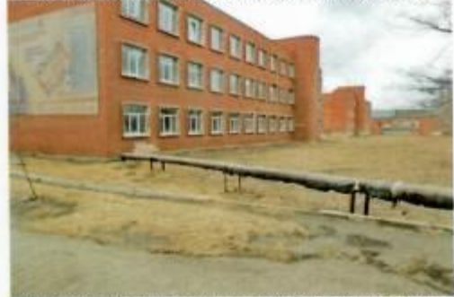
Рис. 4.106 Надземная теплотрасса. Ввод в здание училища
