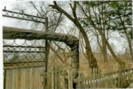
Рис. 4.104 Надземный переход теплотрассы над проездом
