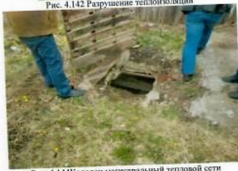
Рис. 4.144 Колодец магистральной тепловой сети
