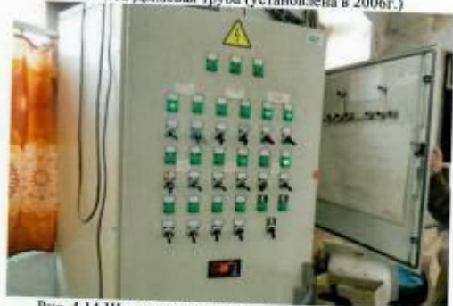
Рис. 4.14 Щит управления насосами и вентиляторами
