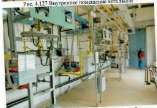
Рис. 4.129 Внутреннее помещение котельной
