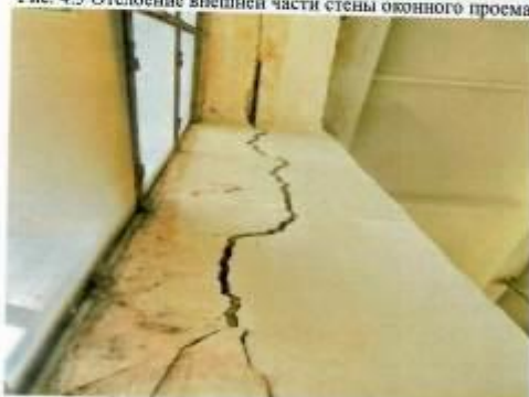
Рис. 4.7 Трещины по несущей стене внутри помещения
