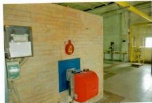
Рис. 4.86 Горелка дизельная котла №4
