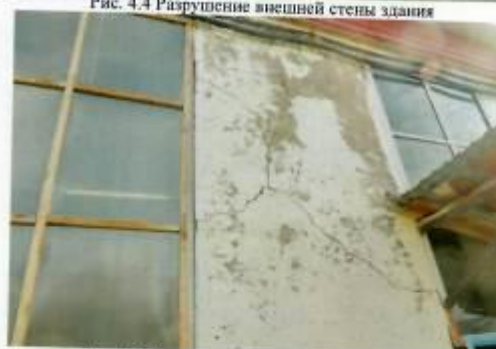
Рис. 4.6 Трещины по стене главного фасада
