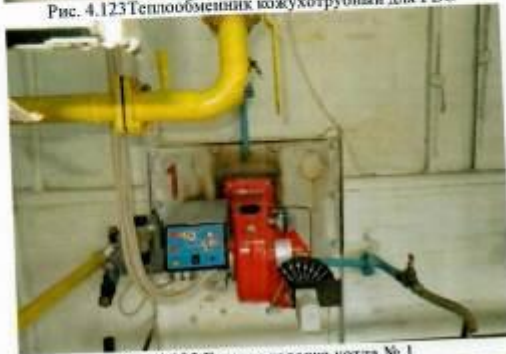
Рис. 4.125 Газовая горелка котла № 1
