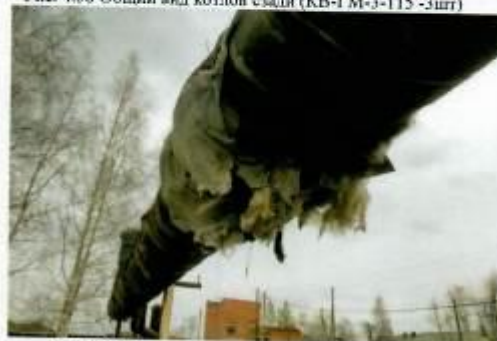
Рис. 4.60 Частичное разрушение теплоизоляции
