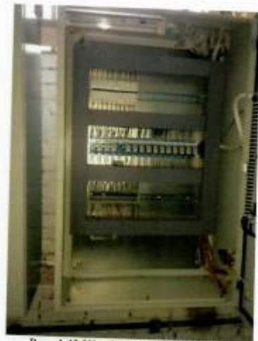
Рис. 4.42 Шкаф управления Котлом
