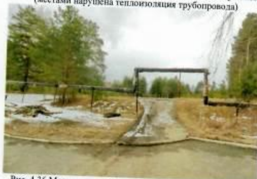
Рис. 4.36 Магистральный компенсатор системы отопления
