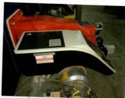
Рис. 4.50 Газовая горелка котла
