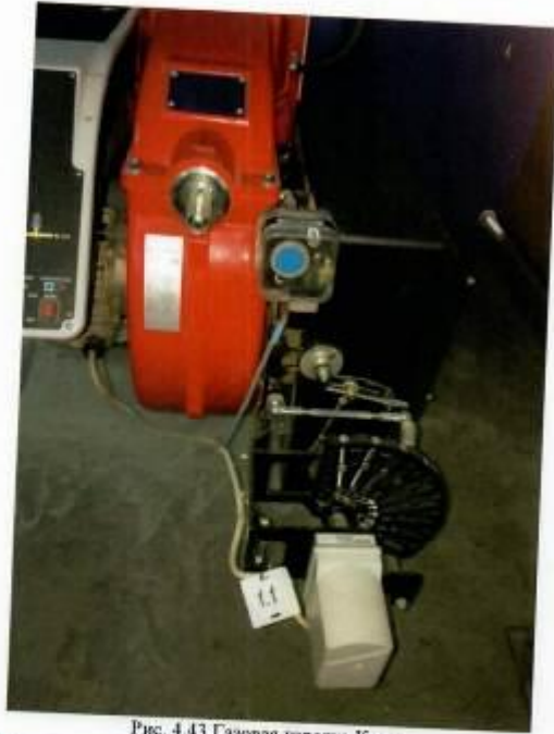
Рис. 4.43 Газовая горелка Котла
