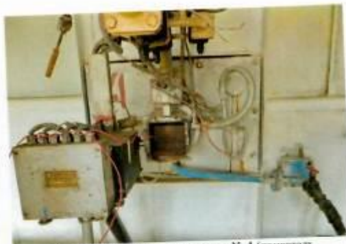
Рис. 4.132 Газовая горелка котла № 4 (двигатель демонтирован)
