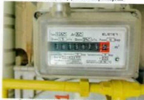
Рис. 4.20 Прибор учета расхода газа котла № 2
