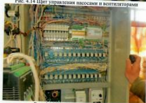
Рис. 4.16 Щит управления котлами
