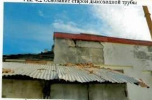
Рис. 4.4 Разрушение внешней стены здания
