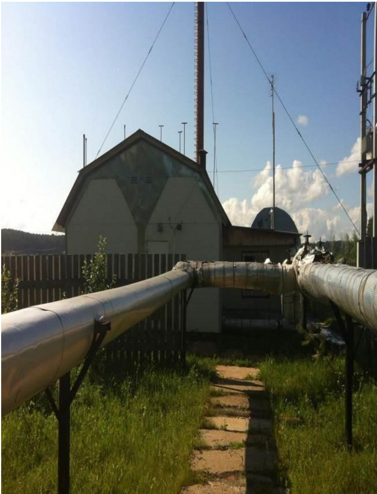
Газовая котельная с. Кашино.
