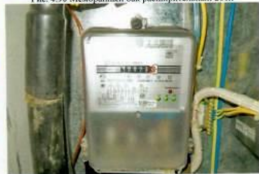
Рис. 4.92 Прибор учета электроэнергии
