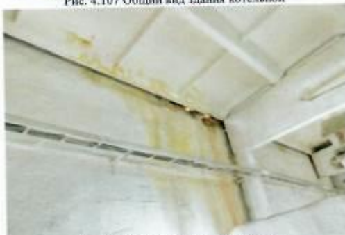
Рис. 4.109 Следы протекания кровли
