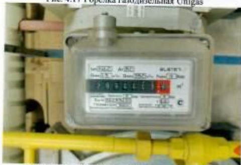
Рис. 4.19 Прибор учета расхода газа котла № 1
