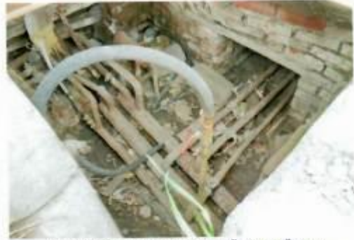
Рис. 4.102 Колодец магистральный тепловой сети
