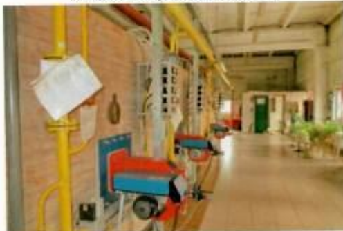
Рис. 4.87 Помещение с водогрейными котлами
