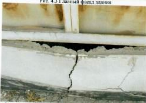
Рис. 4.5 Отслоение внешней части стены оконного проема
