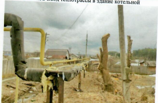
Рис. 4.34 Магистраль системы отопления надземная прокладка (местами нарушена теплоизоляция трубопровода)
