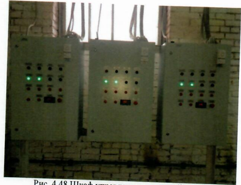
Рис. 4.48 Шкаф управления котлами (3шт)
