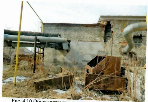
Рис. 4.10 Общее разрушение внешней несущей стены
