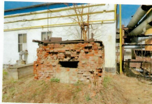
Рис. 4.2 Основание старой дымоходной трубы
