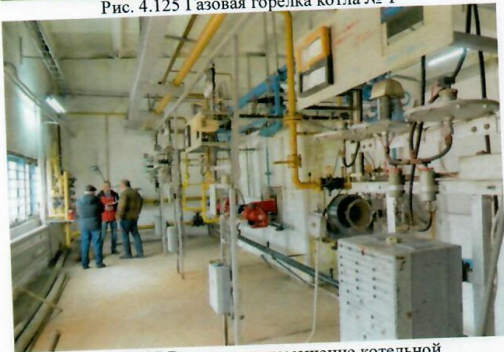
Рис. 4.127 Внутреннее помещение котельной
