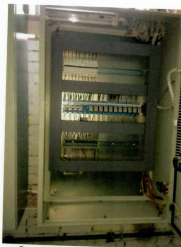
Рис. 4.42 Шкаф управления Котлом
