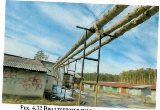
Рис. 4.32 Ввод теплотрассы в здание котельной
