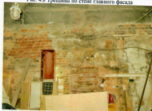
Рис. 4.8 Разрушение кирпичной кладки несущей стены
