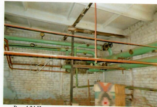
Рис. 4.24 Помещение под дизельную ёмкость (резерв)
