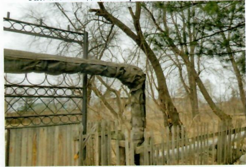
Рис. 4.104 Надземный переход теплотрассы над проездом
