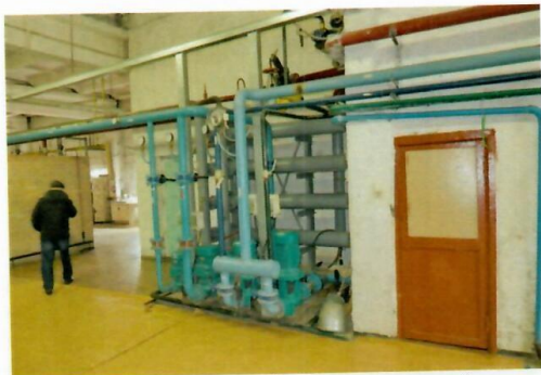
Рис. 4.93 Насосное оборудование котельной
