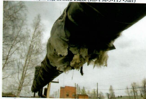
Рис. 4.60 Частичное разрушение теплоизоляции
