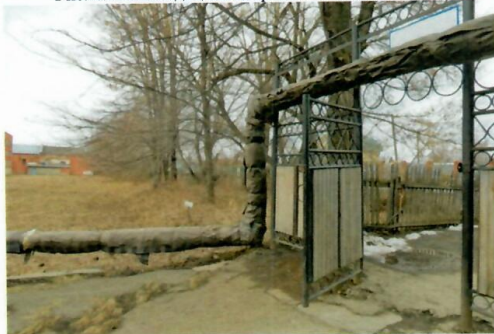
Рис. 4.103 Надземный переход теплотрассы над проездом
