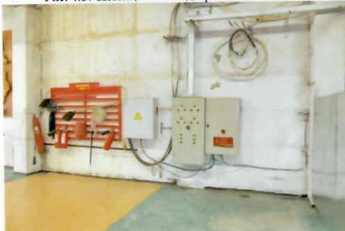
Рис. 4.89 Шкафы управления и учета
