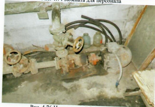
Рис. 4.76 Насос сетевой 2 (неисправен)
