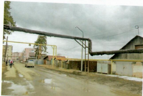
Рис. 4.35 Магистраль системы отопления Т1иТ2 проход НАД дорогой высота +3,8м.
