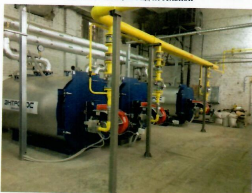
Рис. 4.57 Общий вид котлов (КВ-ГМ-3-115 -3шт)
