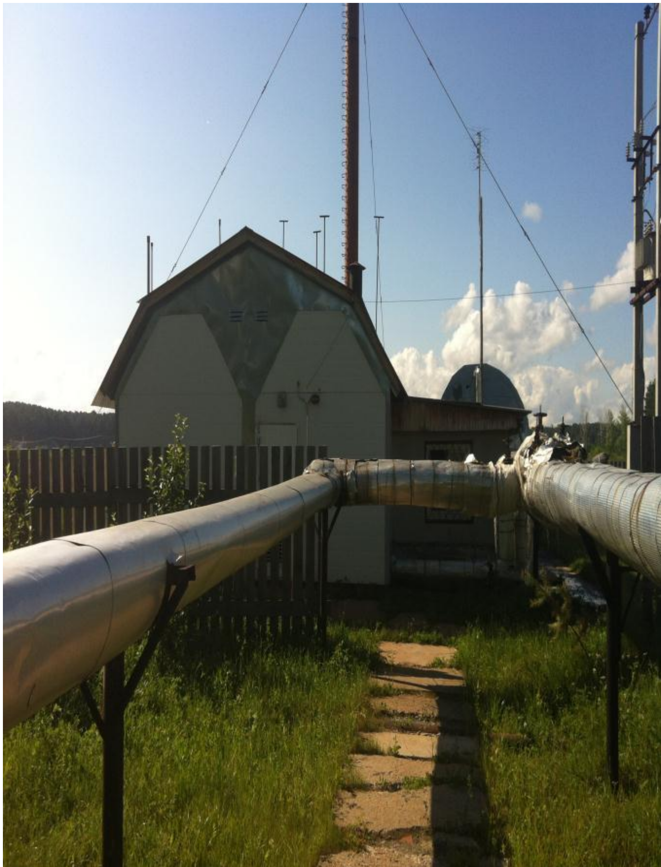
1.2.4. Газовая котельная п. Верхняя Сысерть.
