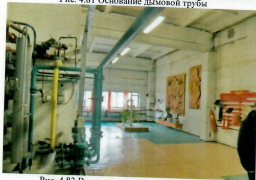
Рис. 4.83 Внутреннее помещение котельной
