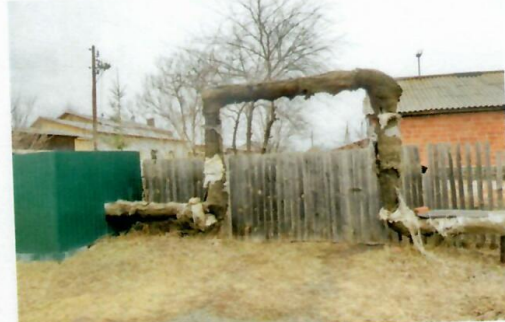
Рис. 4.134 Переход теплотрассы над проездом к жилому дому
