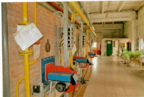
Рис. 4.87 Помещение с водогрейными котлами
