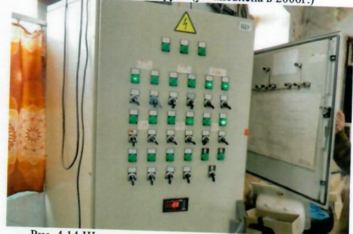
Рис. 4.14 Щит управления насосами и вентиляторами
