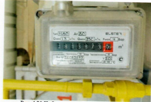
Рис. 4.20 Прибор учета расхода газа котла № 2
