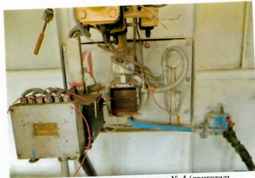
Рис. 4.132 Газовая горелка котла № 4 (двигатель демонтирован)
