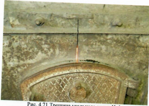
Рис. 4.71 Трещина угольного котла № 1
