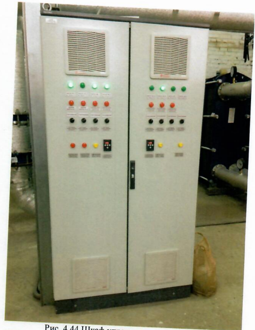
Рис. 4.44 Шкаф управления насосами
