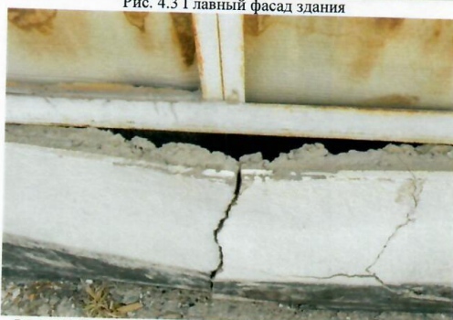
Рис. 4.5 Отслоение внешней части стены оконного проема
