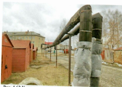
Рис. 4.62 Колодец магистральный тепловой сети Т1иТ2
