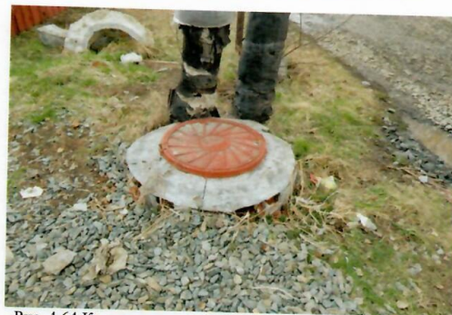
Рис. 4.64 Колодец магистральный тепловой сети Т1иТ2
