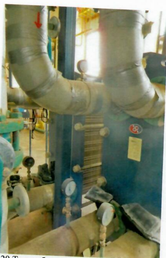
Рис. 4.29 Теплообменники отопления пластинчатые
