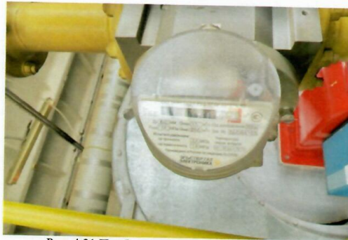
Рис. 4.21 Прибор учета расхода газа котла № 3
