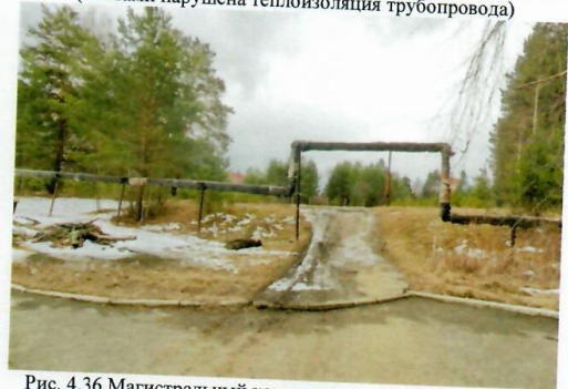
Рис. 4.36 Магистральный компенсатор системы отопления
