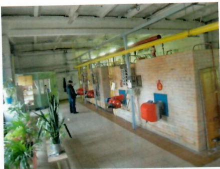
Рис. 4.85 Водогрейные котлы (4 шт.)
