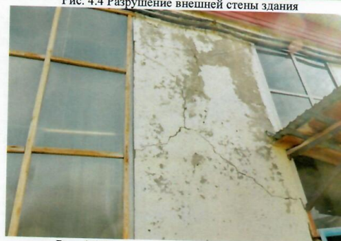
Рис. 4.6 Трещины по стене главного фасада
