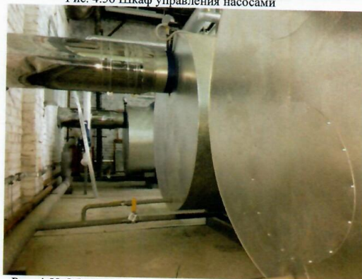
Рис. 4.58 Общий вид котлов сзади (КВ-ГМ-3-115 -3шт)
