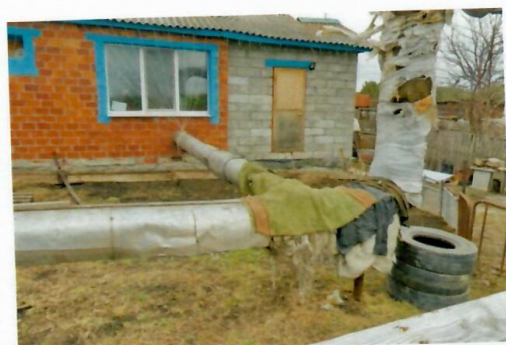
Рис. 4.137 Ввод в жилой дом. Разрушение теплоизоляции
