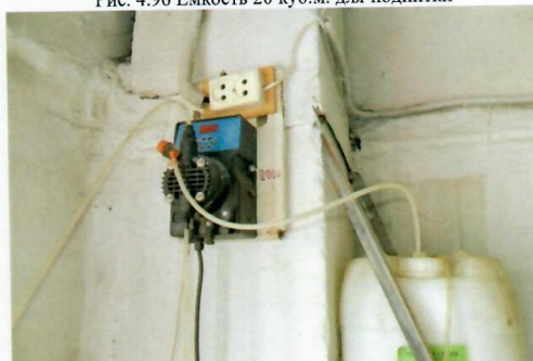
Рис. 4.98 Дозатор хим.водоподготовки с канистрой реагентов СК-110
