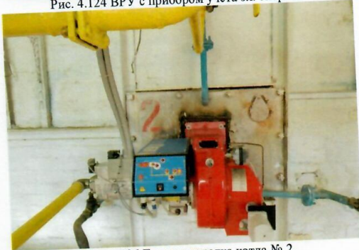
Рис. 4.126 Газовая горелка котла № 2
