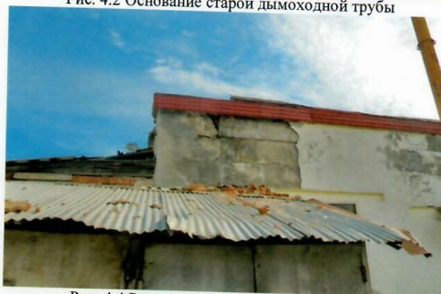
Рис. 4.4 Разрушение внешней стены здания
