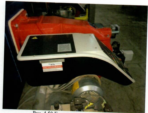
Рис. 4.50 Газовая горелка котла
