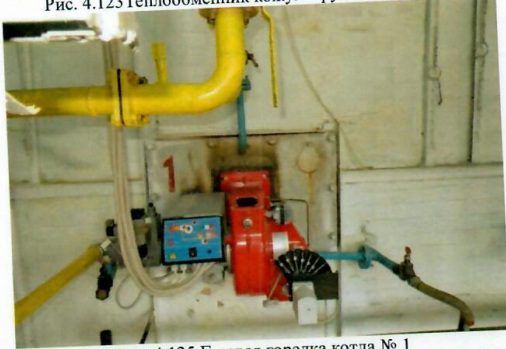
Рис. 4.125 Газовая горелка котла № 1
