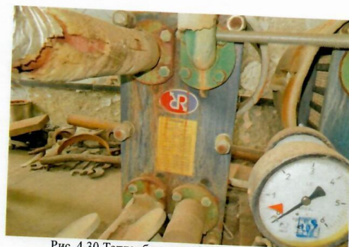
Рис. 4.30 Теплообменники ГВС пластинчатые
