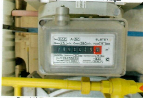
Рис. 4.19 Прибор учета расхода газа котла № 1
