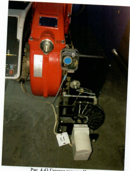
Рис. 4.43 Газовая горелка Котла
